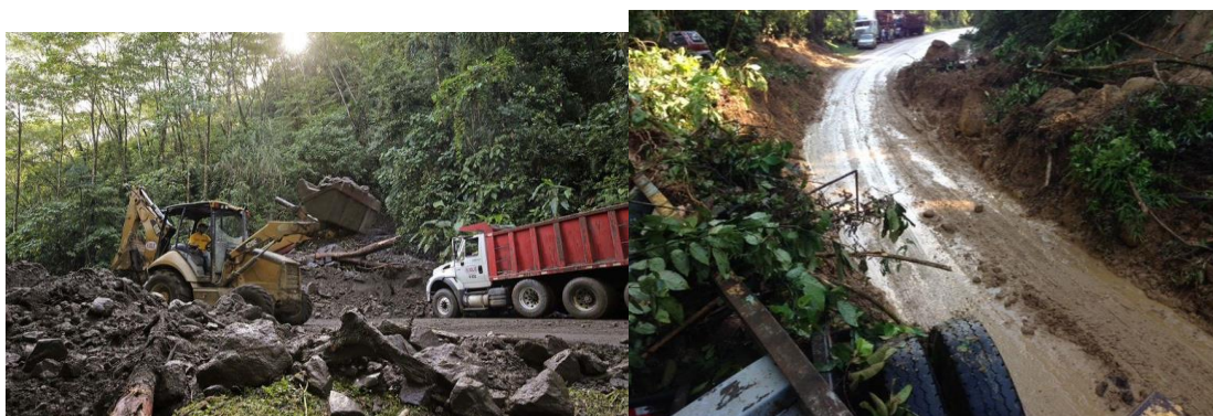
Fig. 30. Daños en la carretera de la ruta 32 por fuertes aguaceros el 18 de setiembre de 2014. Fuente: www.nacion.com .
