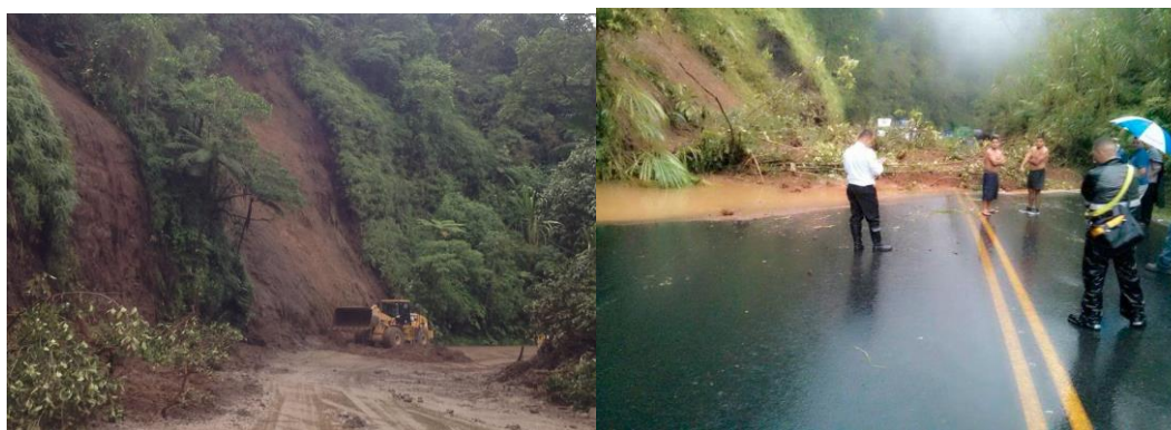
Fig. 31 Daños en la carretera de la ruta 32 por fuertes aguaceros el 18 de setiembre de 2014. Fuente: www.crhoy.com .
