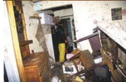
Fig. 17 Imágenes de los daños ocasionados por la tormenta severa del 20 de julio 2010 y que afectó a las ciudades de San Pablo (arriba) y Santo Domingo (abajo) de Heredia. Fuente: Diarios La Nación y Al Día.
