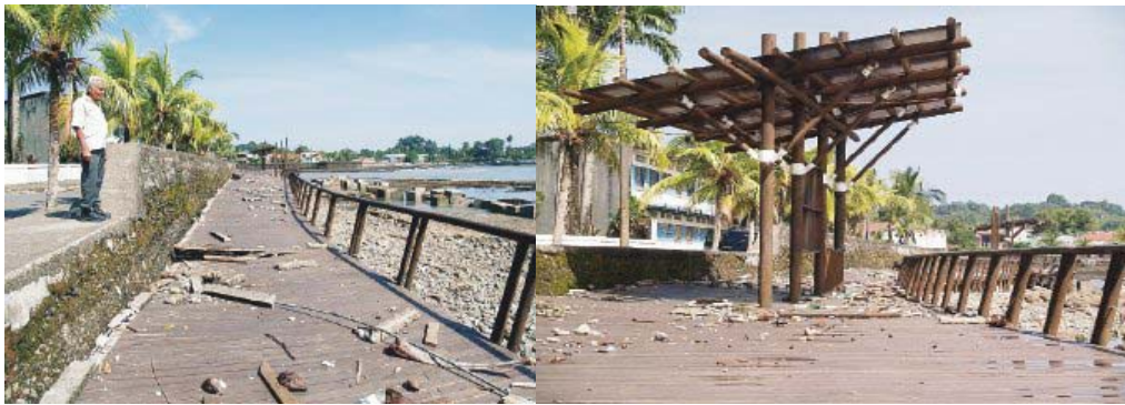
Figura 6. El fuerte oleaje con olas de 2 metros destruyeron el pasaje turístico–en el borde de la ciudad de Limón– en un 90%. El piso quedó muy dañado. Fuente La Nación.
